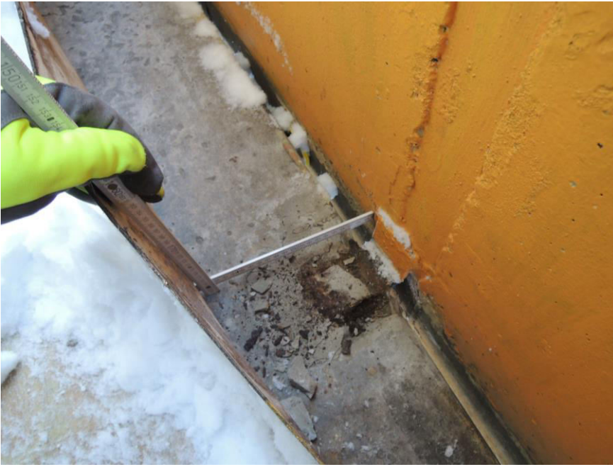
Foto 03. Krt. 20. Roostetanud piirdepaneeli kinnituselement
