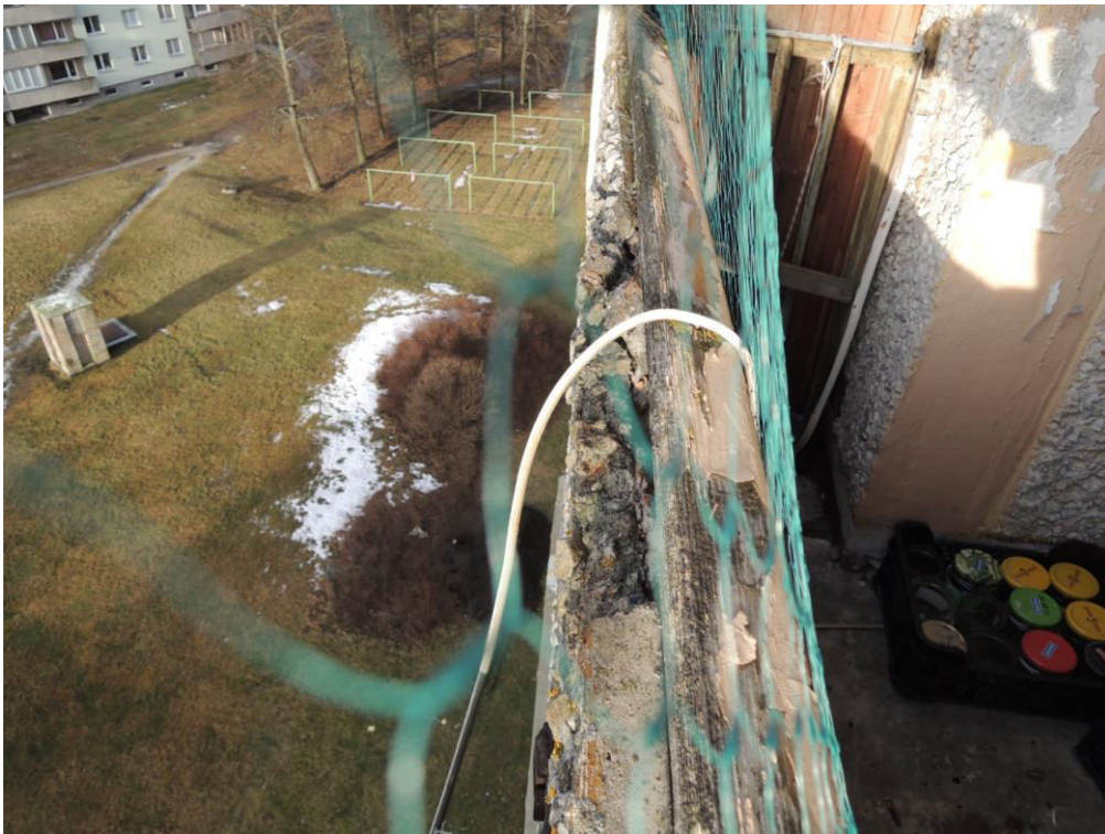
Foto 07. Krt. 64. Pragunenud piirdepaneeli plaat
