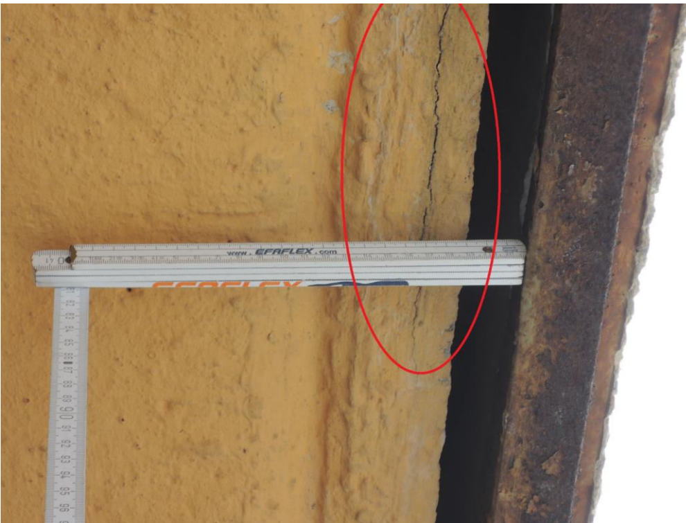
Foto 10. Krt. 75. Pragunenud ülemise vahelaeplaadi serv.
